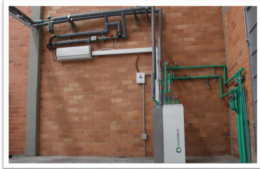
Figura 35 Sistema instalado bomba calor geotérmica proyecto Piloto Parque Industrial la Gran Sabana. [46]
