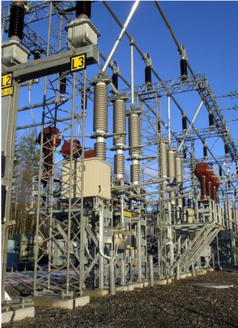
Figura 8 Subestación Prefabricada Modular. Fuente: Universidad Pontificia Comillas [4].
