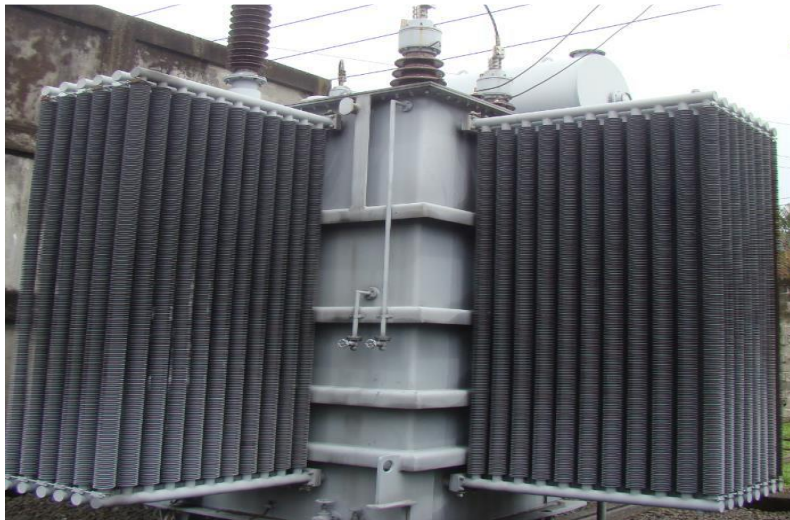
Figura 32 Radiadores de un transformador de potencia. Fuente: CHEC [6].
