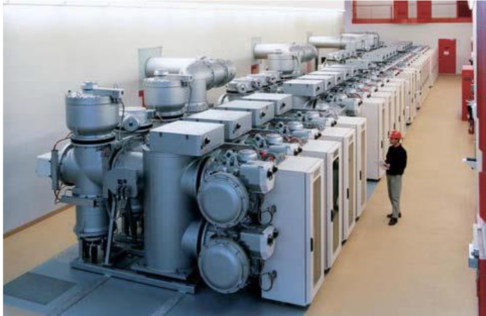
Figura 6 Subestación Eléctrica GIS. Fuente: Universidad Pontificia Comillas [4].
