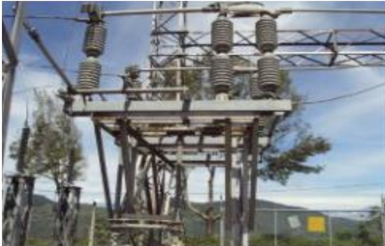
Figura 46 Seccionadores de apertura vertical. Fuente: CHEC [6].
