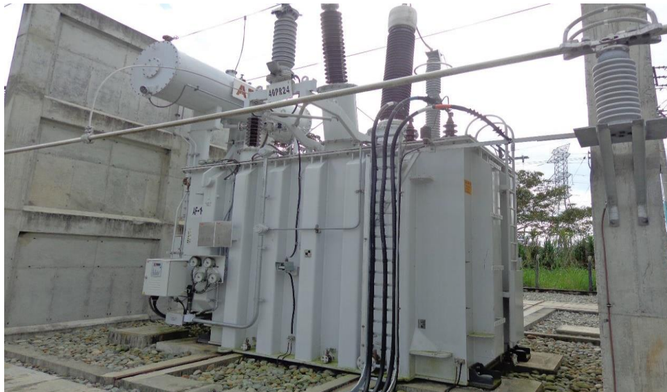
Figura 24 Transformador de potencia. Fuente: CHEC [6].
