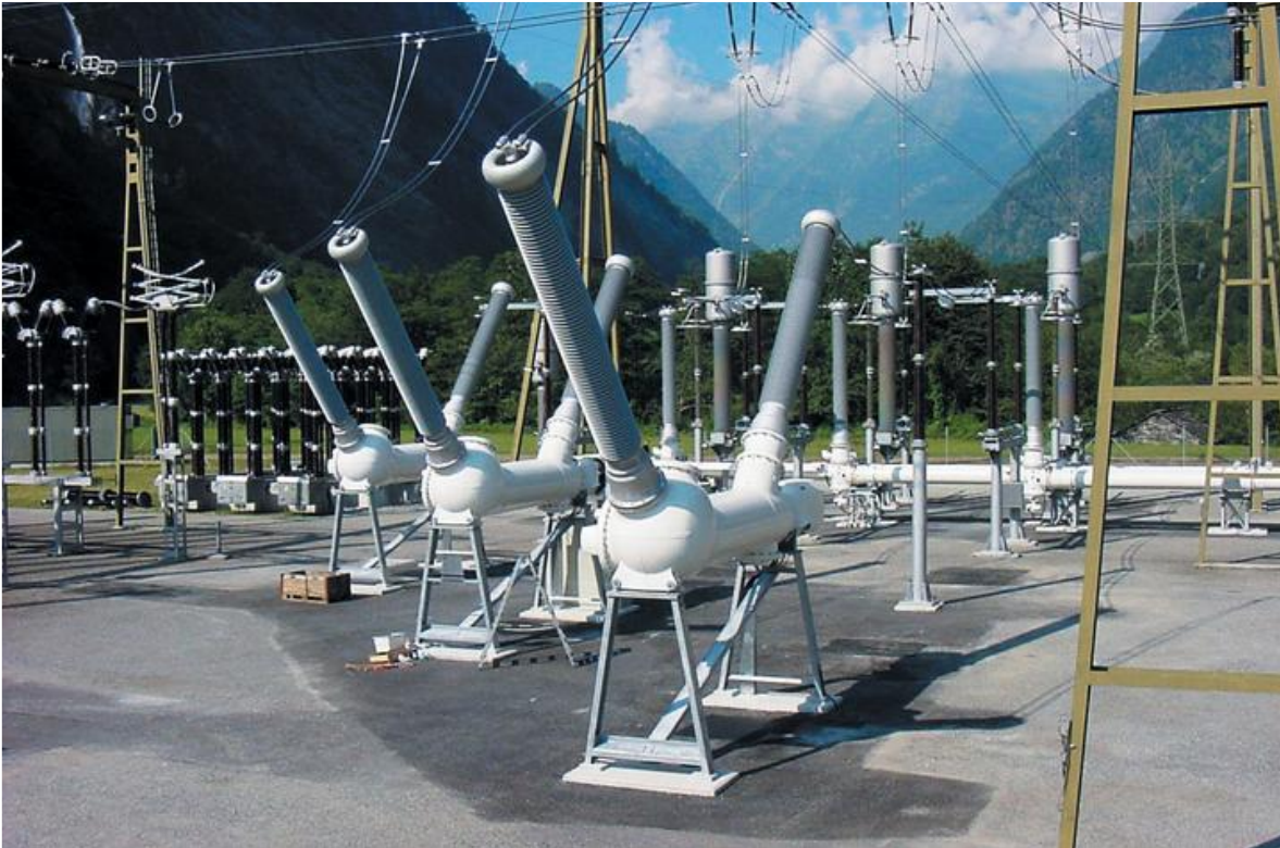
Figura 9 Subestación Híbrida. Fuente: Universidad Pontificia Comillas [4].
