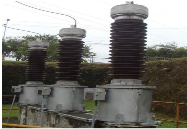
Figura 51 Transformadores de potencial PT's capacitivos. Fuente: CHEC [6].
