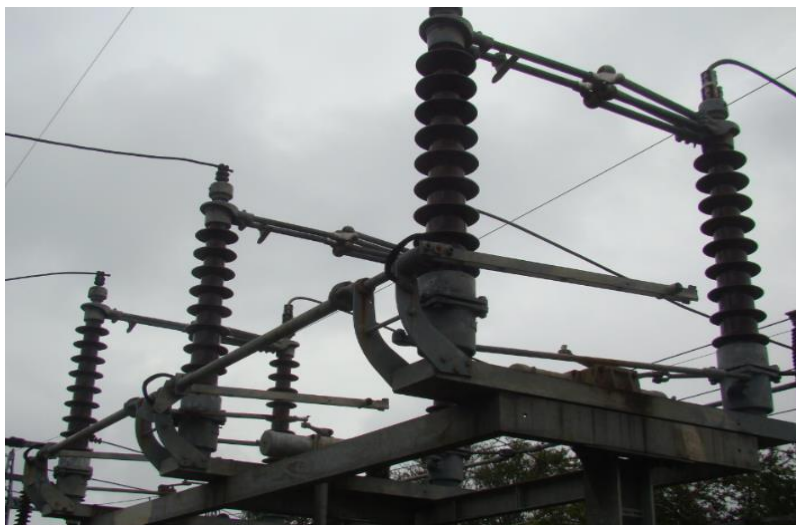
Figura 42 Seccionadores de línea con función de puesta a tierra. Fuente: CHEC [6].
