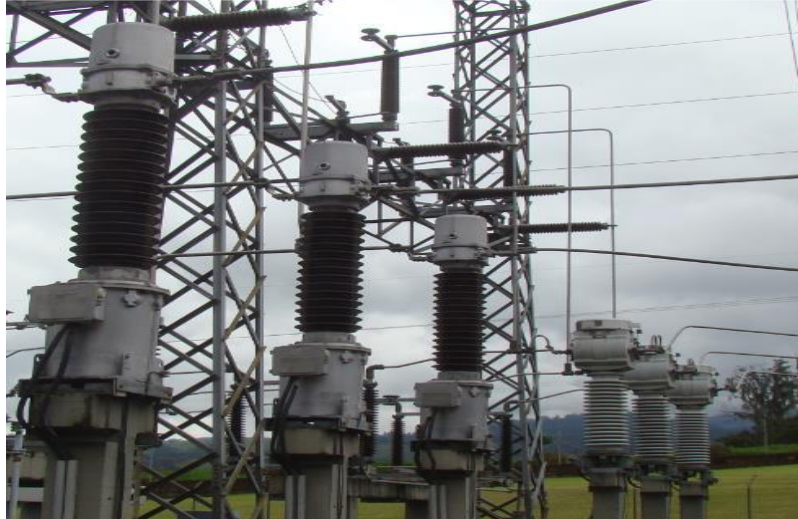
Figura 52 Transformadores de corriente. Fuente: CHEC [6].
