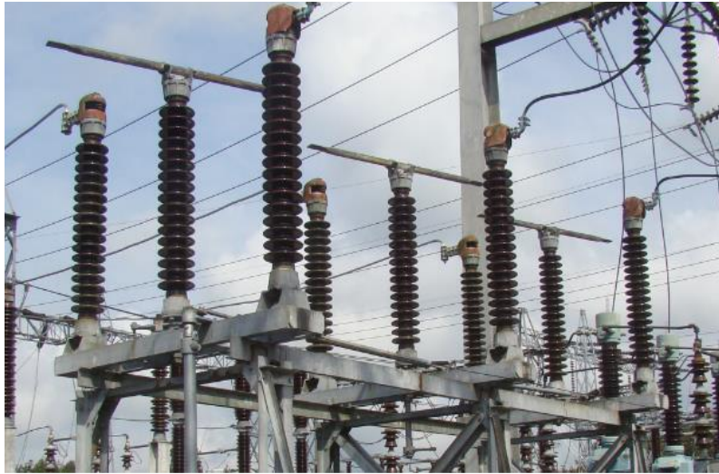
Figura 44 Seccionadores de apertura central. Fuente: CHEC [6].
