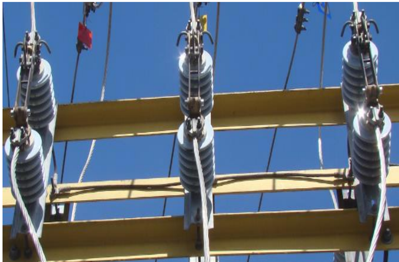
Figura 45 Seccionadores de cuchilla. Fuente: CHEC [6].
