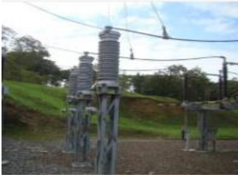
Figura 59 Descargadores de sobretensión de carburo de silicio. Fuente: CHEC [6].
