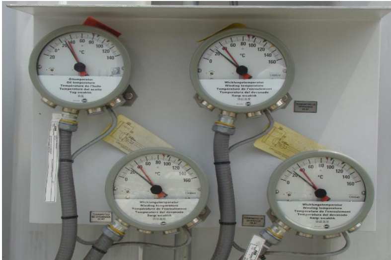
Figura 31 Indicadores de temperatura de un transformador de potencia. Fuente: CHEC [6].
