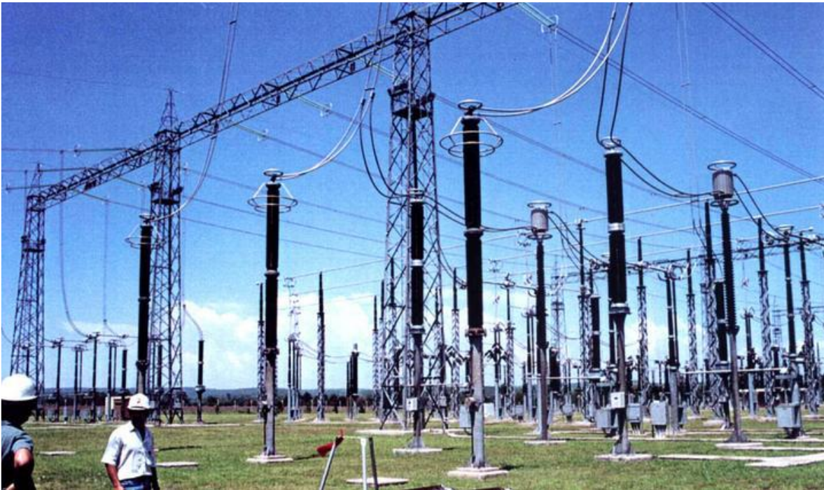
Figura 5 Subestación Eléctrica AIS. Fuente: Universidad Pontificia Comillas [4].
