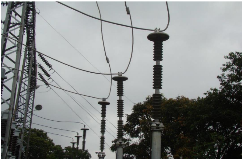
Figura 57 Descargadores de sobretensión. Fuente: CHEC [6].
