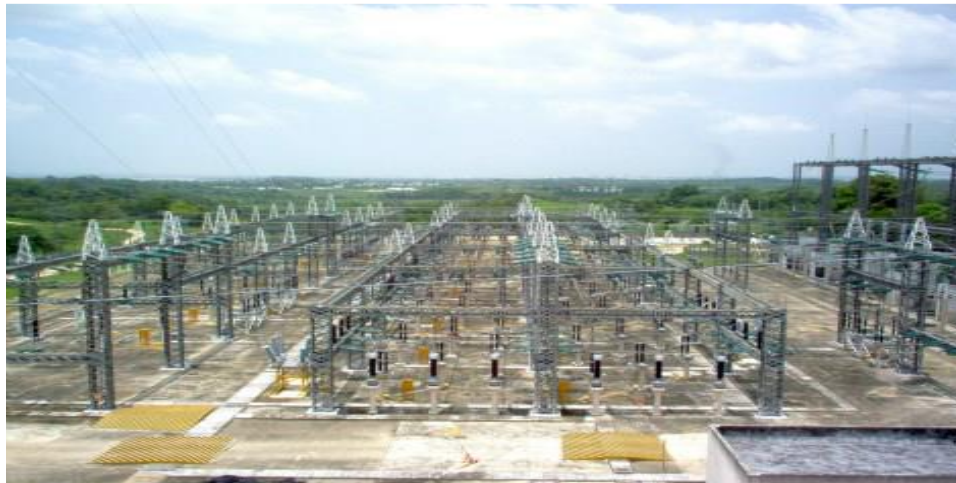
Figura 4 Subestación Eléctrica de maniobra. Fuente: Instituto tecnológico de Los Mochis [3].
