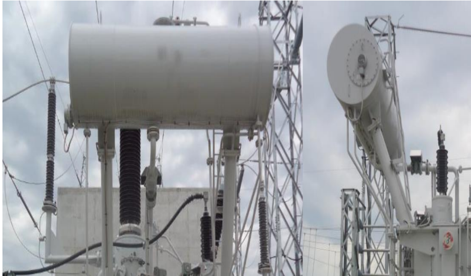
Figura 27 Tanque conservador de un transformador de potencia. Fuente: CHEC [6].
