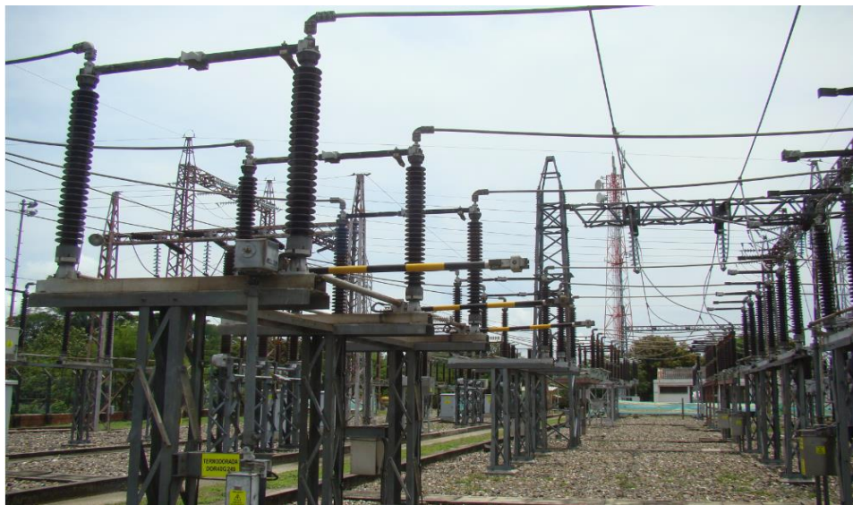
Figura 40 Seccionadores de línea. Fuente: CHEC [6].
