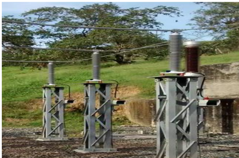
Figura 58 Descargadores de sobretensión de óxido de Zinc. Fuente: CHEC [6].
