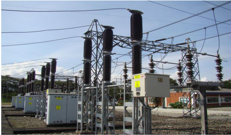
Figura 33 Interruptores de potencia. Fuente: CHEC [6].
