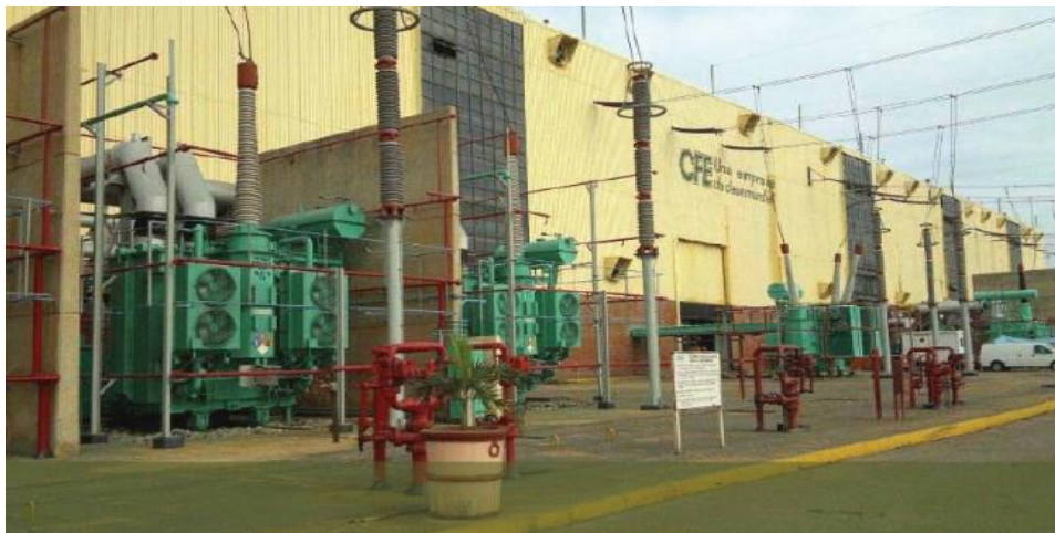
Figura 2 Subestación Eléctrica elevadora. Fuente: Instituto tecnológico de Los Mochis [3].
