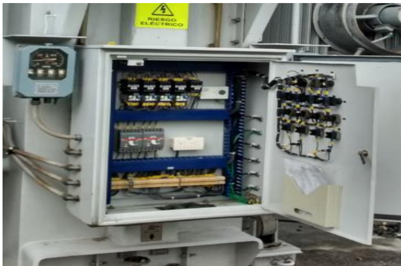
Figura 29 Tablero general de un tablero de potencia. Fuente: CHEC [6].
