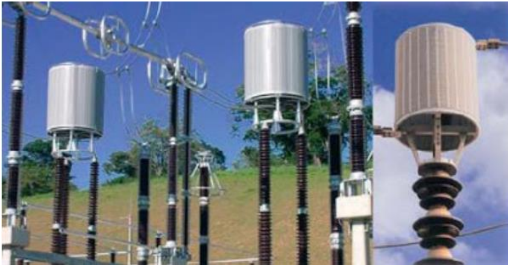
Figura 63 Trampa de onda en una subestación de patio a la intemperie. Fuente: Sector electricidad [10].
