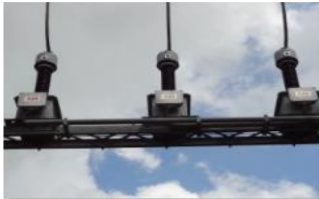
Figura 50 Transformadores de potencial PT's inductivos. Fuente: CHEC [6].
