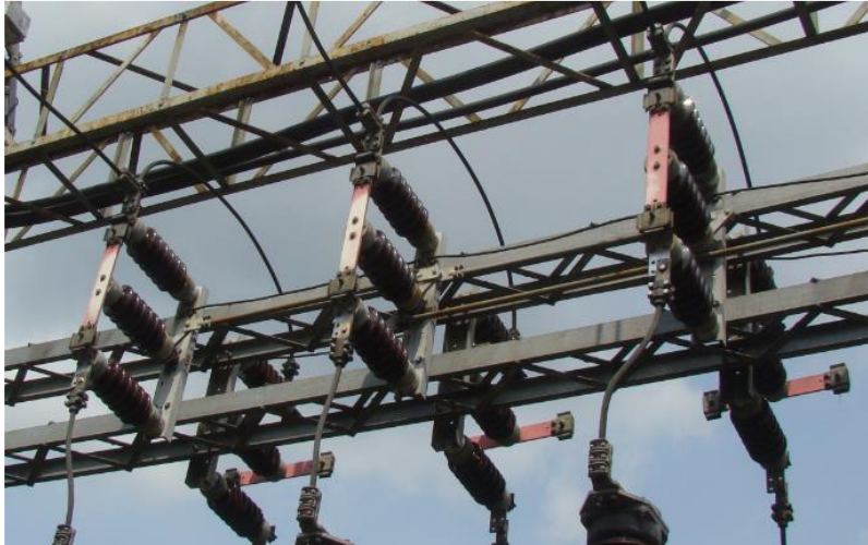
Figura 41 Seccionadores de barra y de línea. Fuente: CHEC [6].
