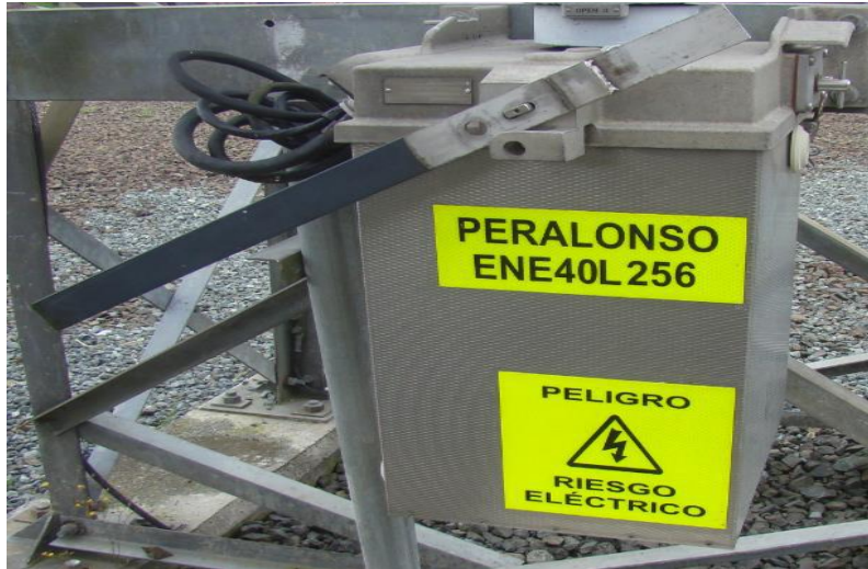
Figura 48 Accionamiento motorizado de seccionadores. Fuente: CHEC [6].
