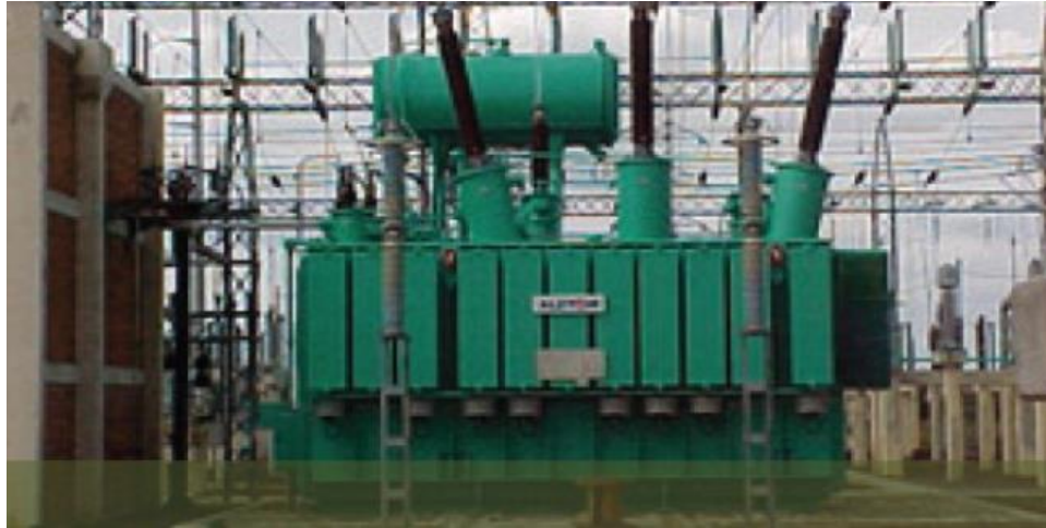
Figura 3 Subestación Eléctrica reductora. Fuente: Instituto tecnológico de Los Mochis [3].
