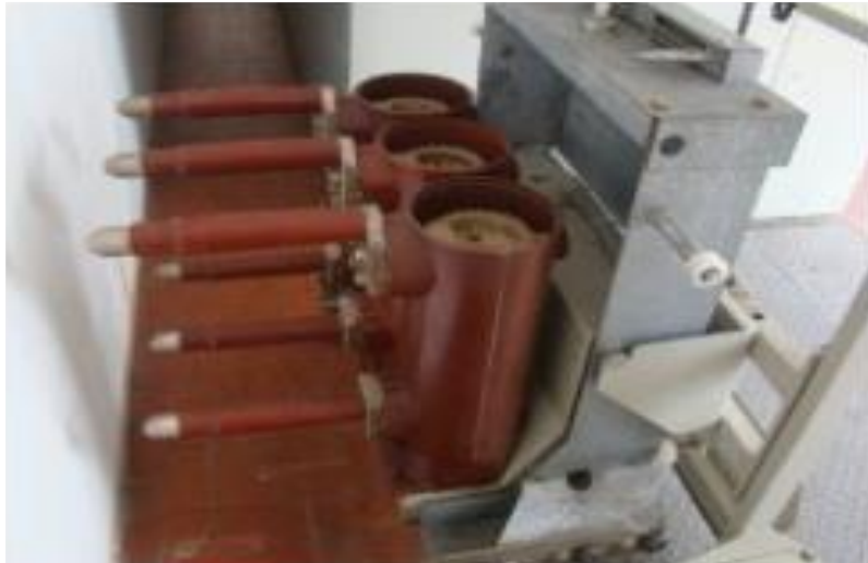
Figura 37 Interrupción al vacío. Fuente: CHEC [6].
