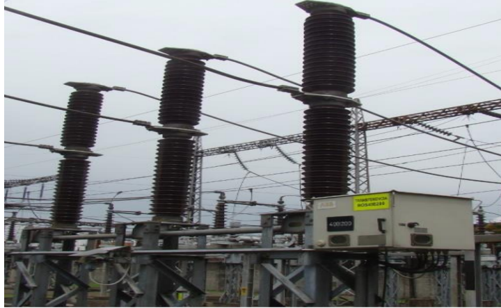
Figura 36 Interruptor de potencia tipo exterior. Fuente: CHEC [6].
