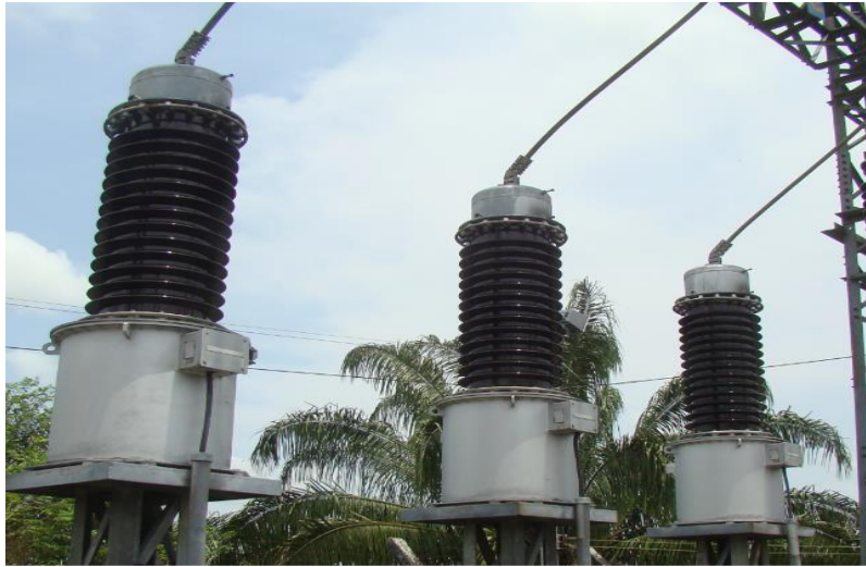
Figura 49 Transformadores de potencial PT's. Fuente: CHEC [6].
